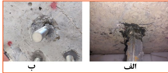
شکل (۵): نمایشی از ترک و گسیختگی گوه‌ای شکل در سطح بتن.
